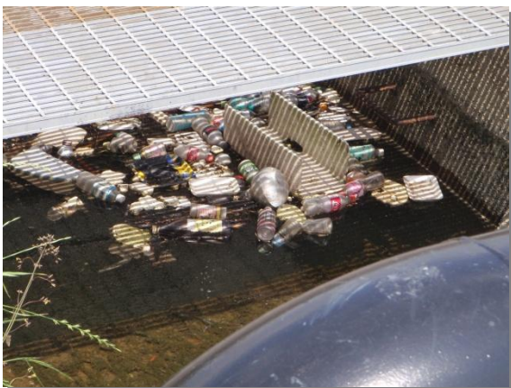
水路に詰まったごみ
