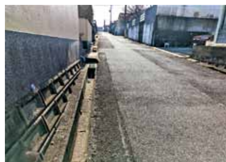
みくに野団地内の未整備側溝
