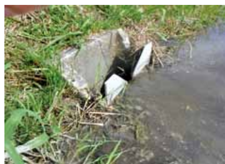
田んぼダム (排水マスに設置されたセキ板)
