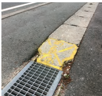
確認はしているが 未補修の歩道
