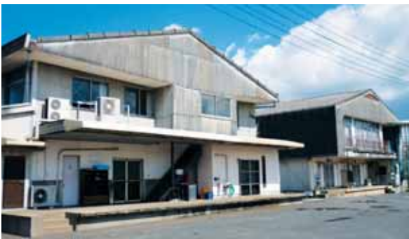
▲老朽化が進んでいる小都市立給食センター
