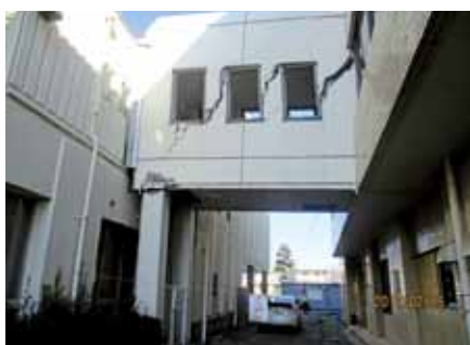
▲大きな亀裂が入り傾いた渡り廊下
