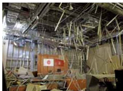
▲天井や壁が崩落した議場
