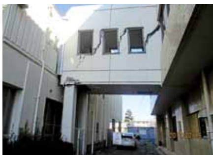
▲大きな亀裂が入り傾いた渡り廊下
