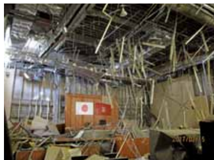
▲天井や壁が崩落した議場
