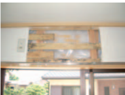
▲内壁の下地板に発生したカビ
