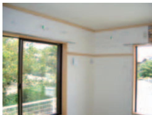
▲内壁に発生したカビ
